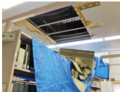
天井落下(3階図書閲覧室) (2020/06/25撮影)
