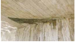
築50年経過後のRC部材の変状
