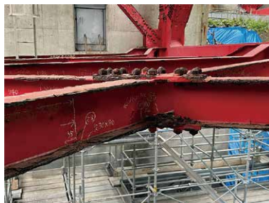
経年に伴う腐食損傷した鋼トラス橋
