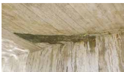
築50年経過後のRC部材の変状
