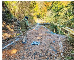
▲実際の崩落現場
