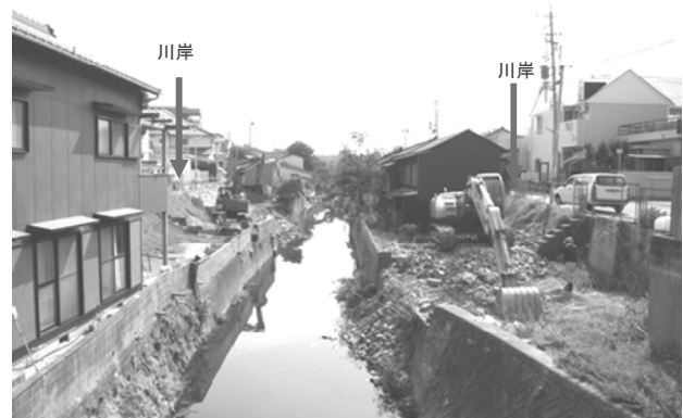
写真-1 中橋下流の河道内住宅(2008.10.08撮影)
