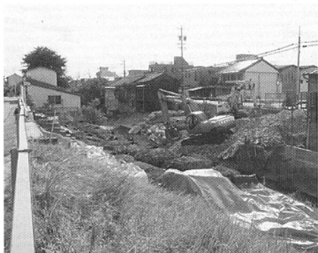
伊賀川の洪水で崩壊した住宅（愛知県岡崎市で）。
